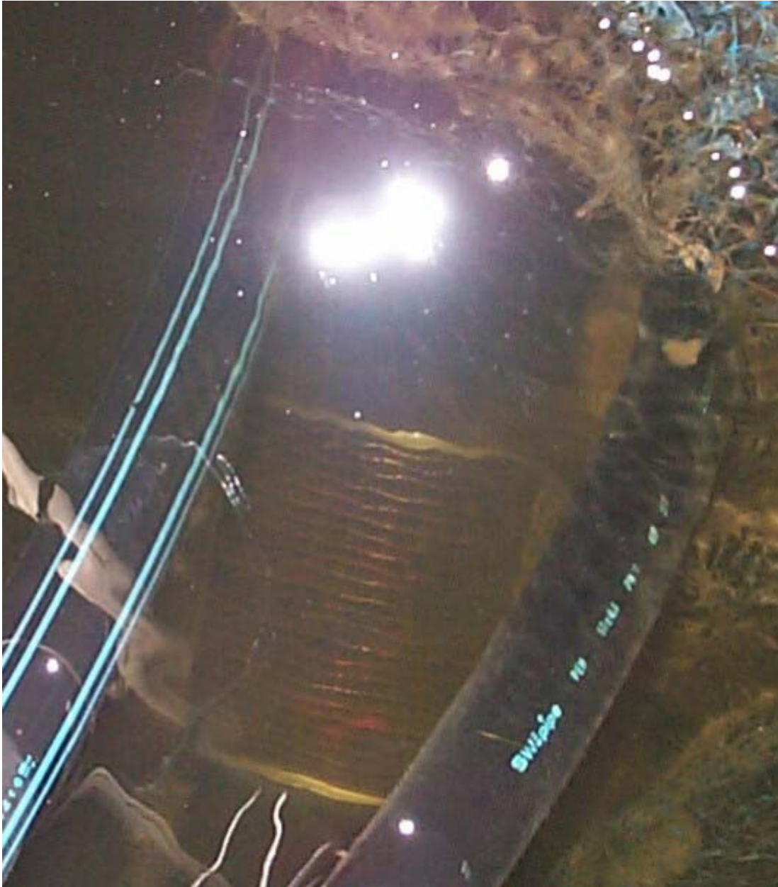
PSHE kollektorn, diameter 300
